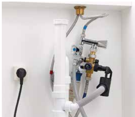
Mehr Platz und Ordnung im Spülenunterschrank: links mit dem 4-Wege-Verteiler „Water Box“, rechts ohne.
